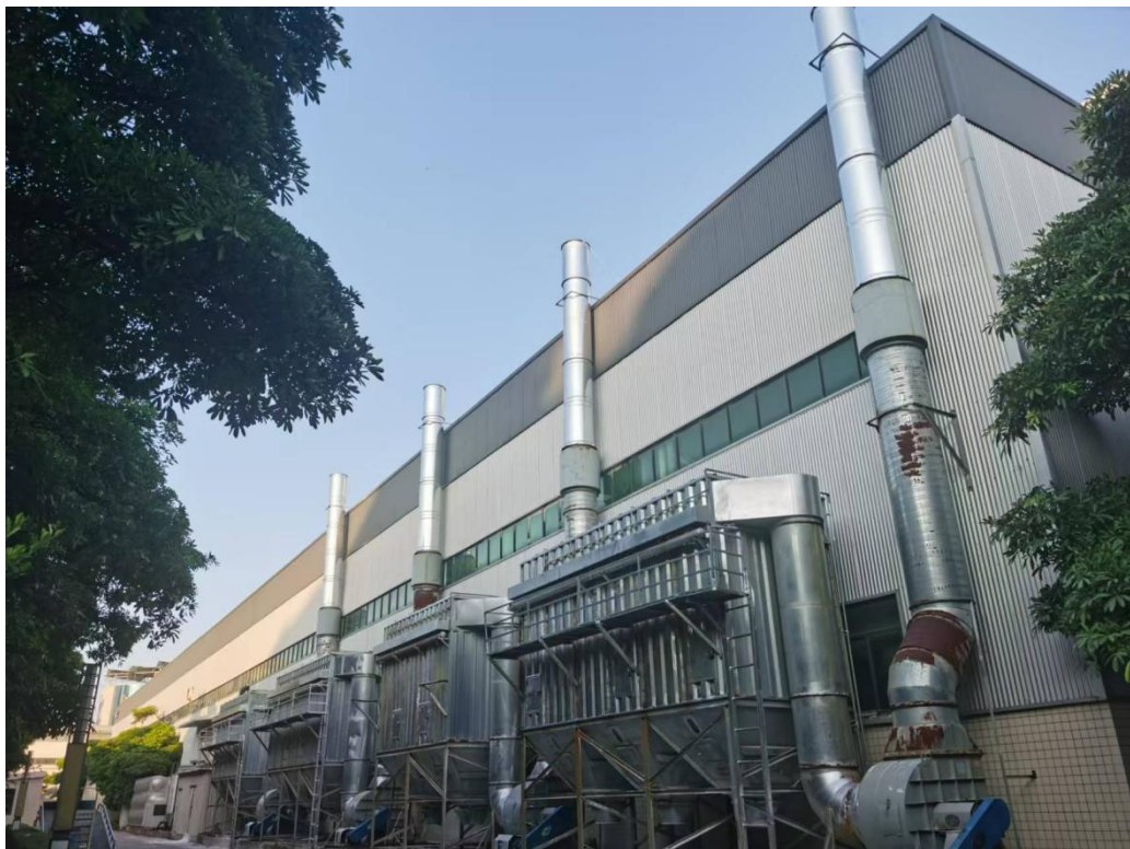
项目废气排气筒
